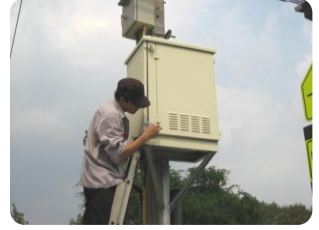
True Corp. (ไทยแลนด์), กุมภาพันธ์, 2010: ตู้เย็นเครื่องปรับอากาศลดลงถึง 10 องศา ปกป้องระบบเทคโนโลยีภายใน
