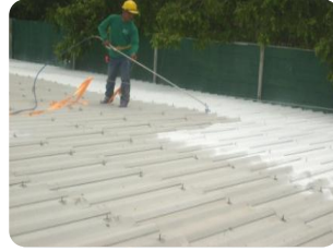
Bouygues-Thai สำนักงาน (ไทยแลนด์), กรกฎาคม, 2010: 49% ประหยัดค่าเครื่องปรับอากาศ
